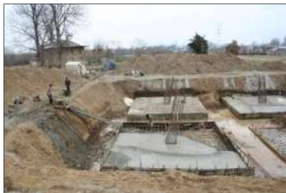
عدم امکان استقرار بتن ریز در محل احداث برجها و بتن ریزی دستی
