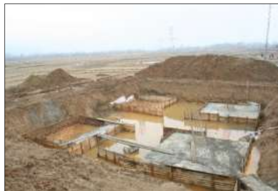
بالا بودن سطح آب و مشکلات احداث فونداسیون پایه‌ها
